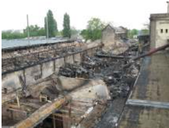
A károsodott épületek
