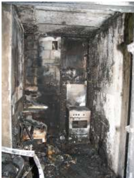
9 sz. kép. A VI. emeleti lakás konyhájának belső képe, az áthelyezett tűzhellyel (tűzkeletkezési hely). Megfigyelhető a gépészeti akna jó tűzállóságú Ytong falszerkezete és az eredeti szageszívó csatlakozás (fotó: Takács Lajos Gábor)
