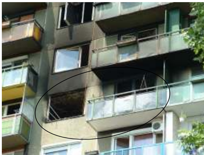
8 sz. kép. A Budapest, XV. Páskom park 35 sz. alatti épület homlokzati részlete; a legalsó károsodott lakás a tűzkeletkezési hely a VI. emeleten (fotó: Takács Lajos Gábor)
