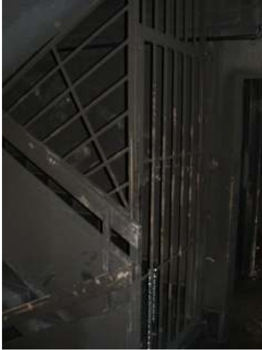
11 sz. kép. A tetőszintre vezető lépcsőházat lezáró rács, mögötte a hő- és füstelvezető működtető szerkezete (fotó: Takács Lajos Gábor)
