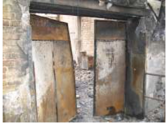
Nem megfelelő tűzállóságú ajtó két csarnok között
