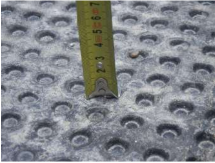
A szigetelés felső rétege perforálódott
